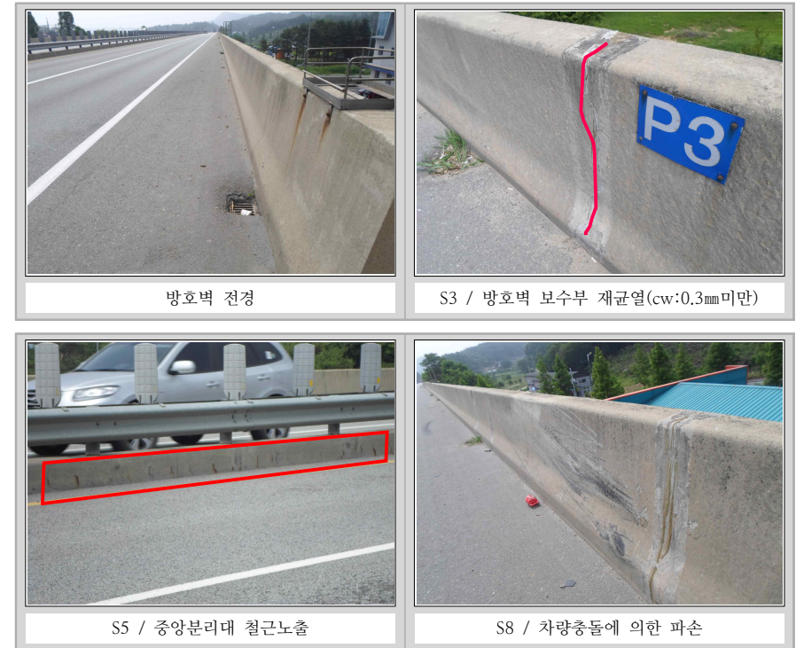
〈그림 2.1.15〉 난간 및 연석 현황 및 손상사진
