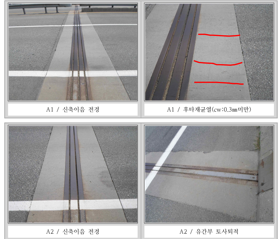
〈그림 2.1.11〉 신축이음 현황 및 손상사진
