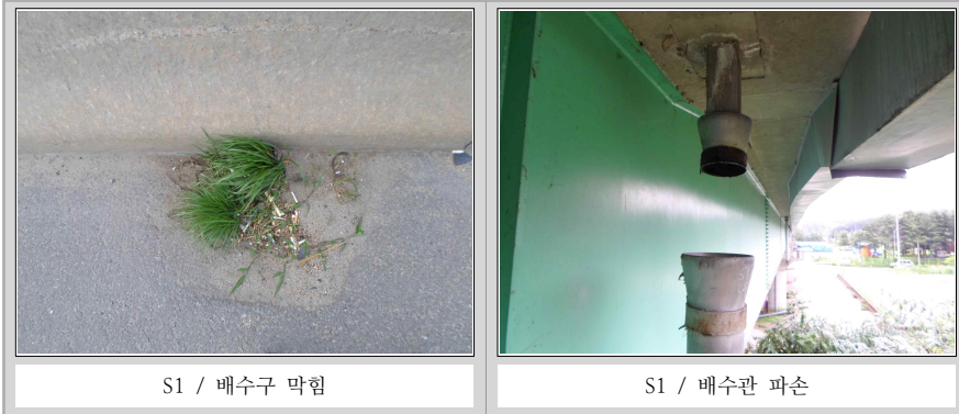
〈그림 2.1.14〉 배수시설 현황 및 손상사진
