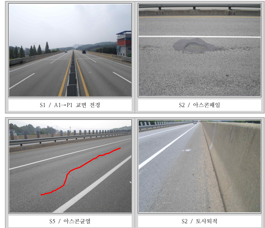
〈그림 2.1.13〉 교면포장 현황 및 손상사진
