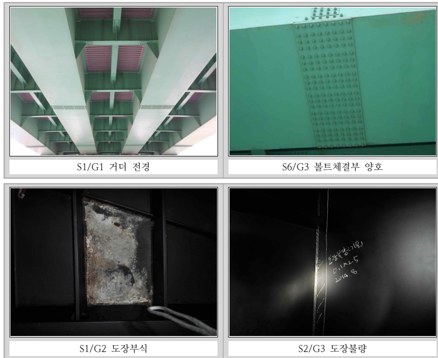
〈그림 2.1.3〉 거더 현황 및 손상사진
