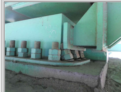
P6/Sh3 이동제한장치 볼트 파손
