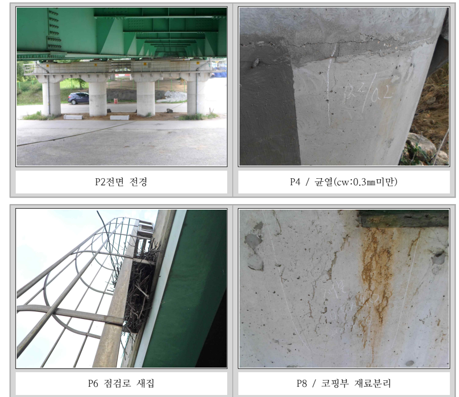
〈그림 2.1.6〉 교대 현황 및 손상사진
