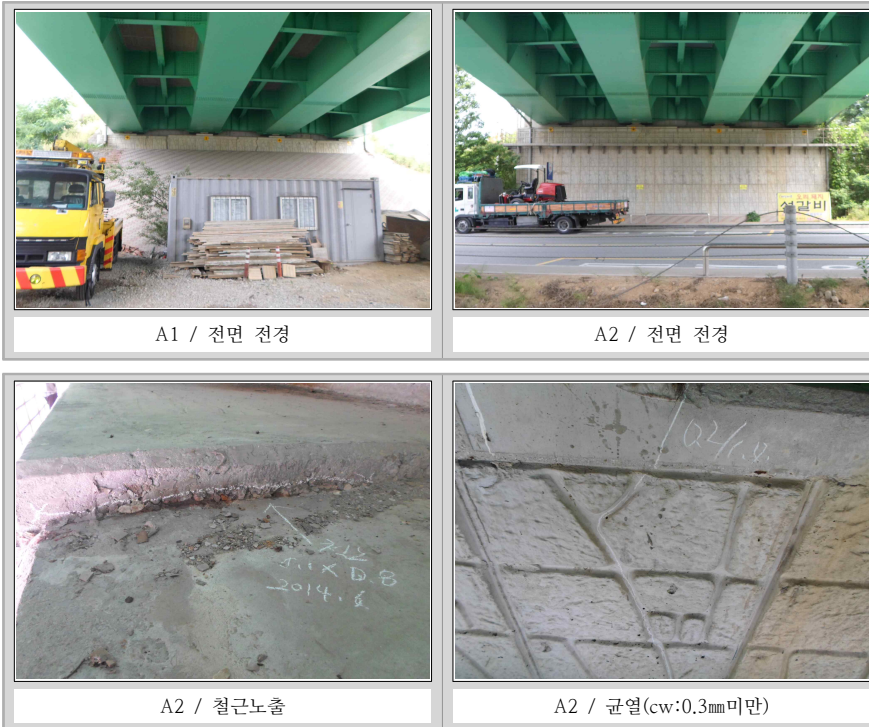
〈그림 2.1.5〉 교대 현황 및 손상사진
